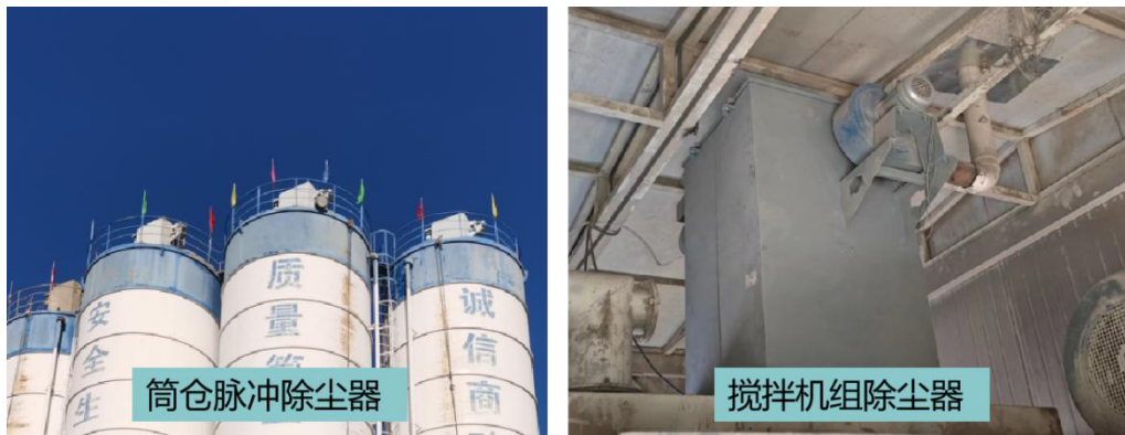
图 3-1 项目除尘设备照片
